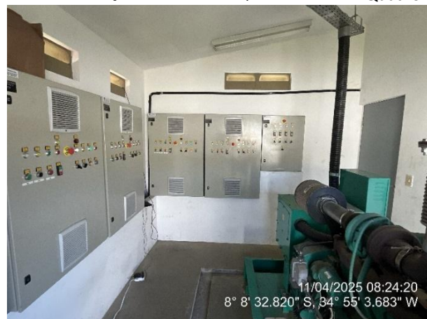
Quadros de comando
