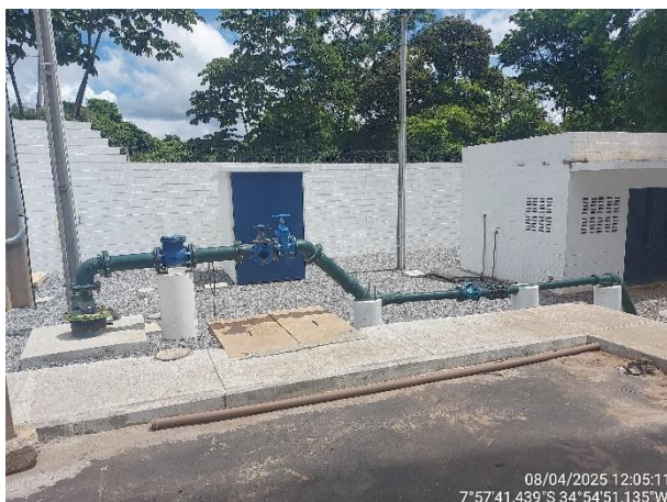
Poço Parque Recife
