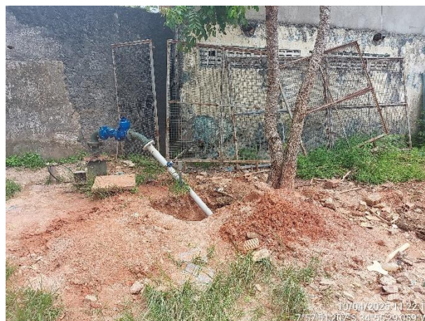
Poço Bola na Rede 14-2 (colapsado)
