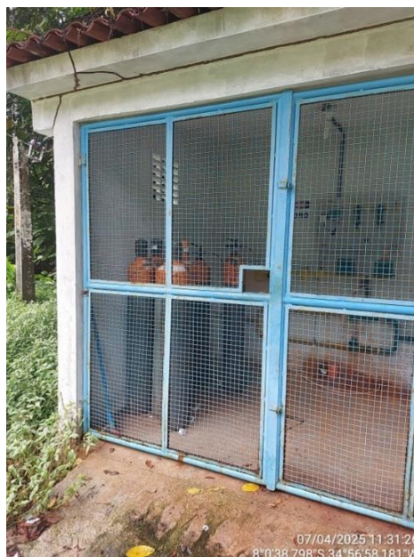
Figura 4.68 – Poço de sucção e armazenamento de cloro gás na EEAT Macacos
