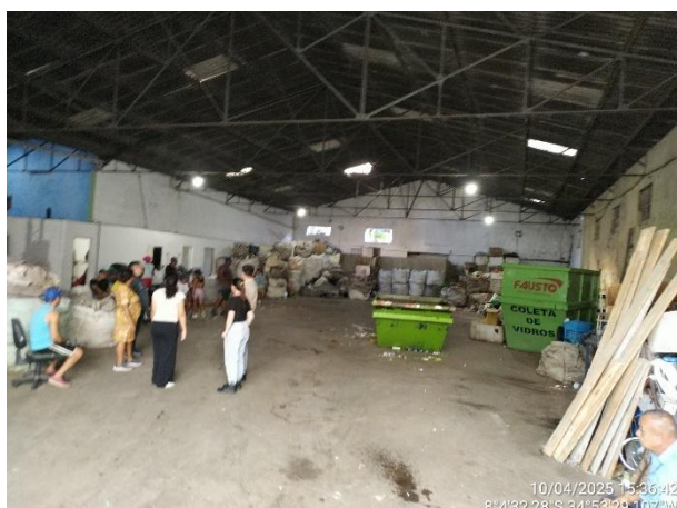
Galpão sem ventilação adequada
