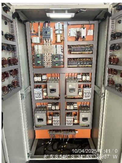
Quadro de comando
