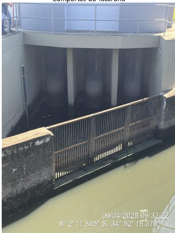
Reservatório de sucção
