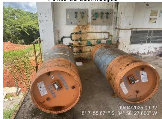
Armazenamento de cloro gás
