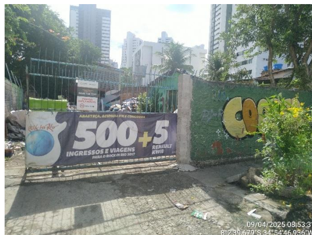
Muro com problemas estruturais
