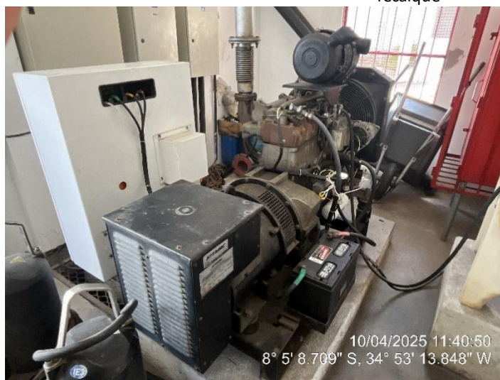
Gerador de energia
