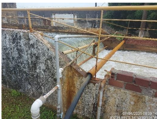
Chegada de água bruta na Calha Parshall com aplicação de coagulante
