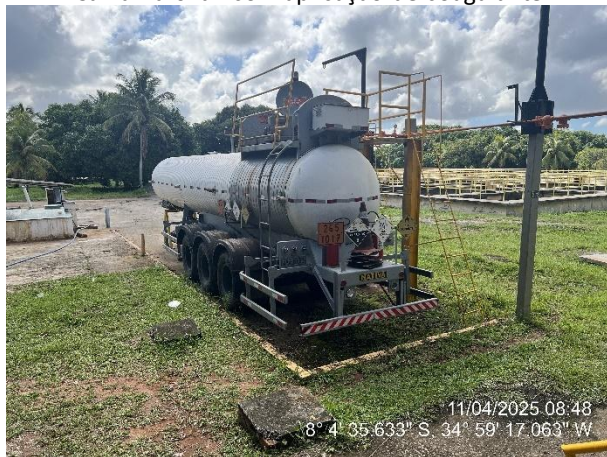
Armazenamento de cloro
