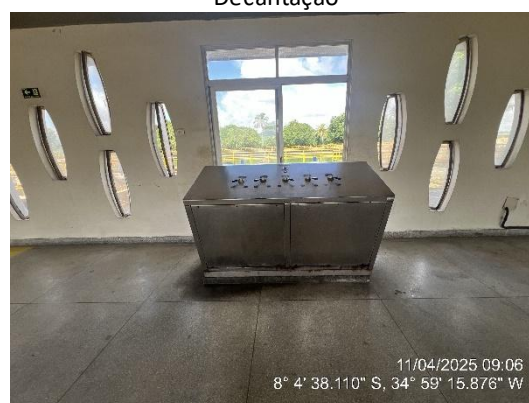
Painel de manobras dos filtros
