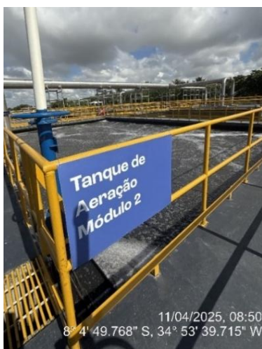
Tanque de aerção
