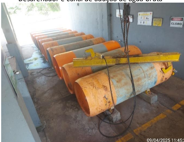
Armazenamento de cloro
