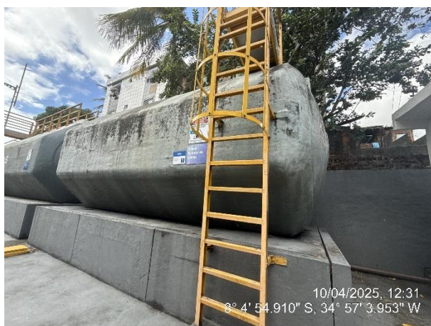
Tanque retentor de sólidos
