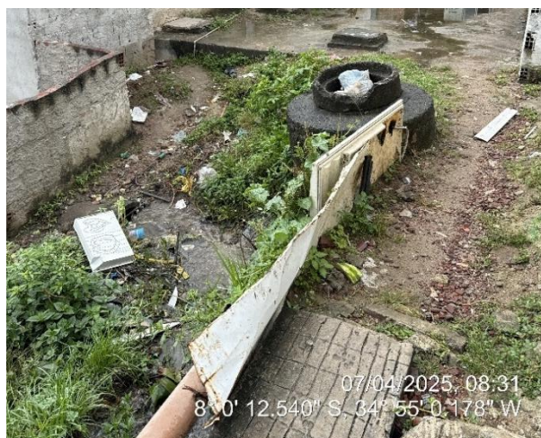
Fossa inativa Conjunto Hab. Josué Pinto
