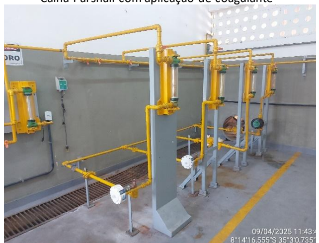
Sistema de bombeamento de cloro
