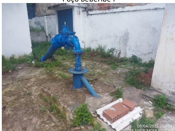
Poço Hidelbrando de Vasconcelos I
