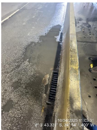
Ponto de coleta de águas pluviais
