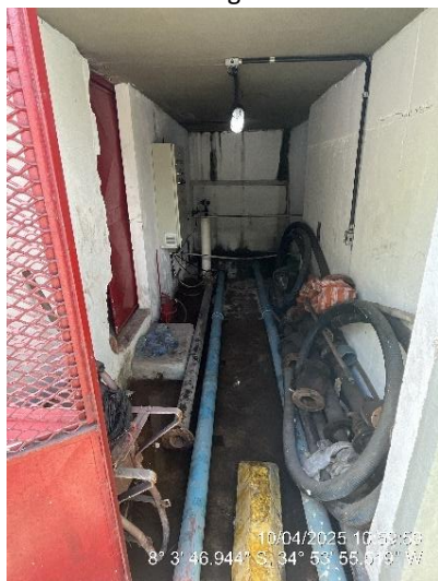
Tubulação de recalque
