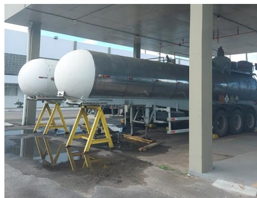
Armazenamento de cloro gás
