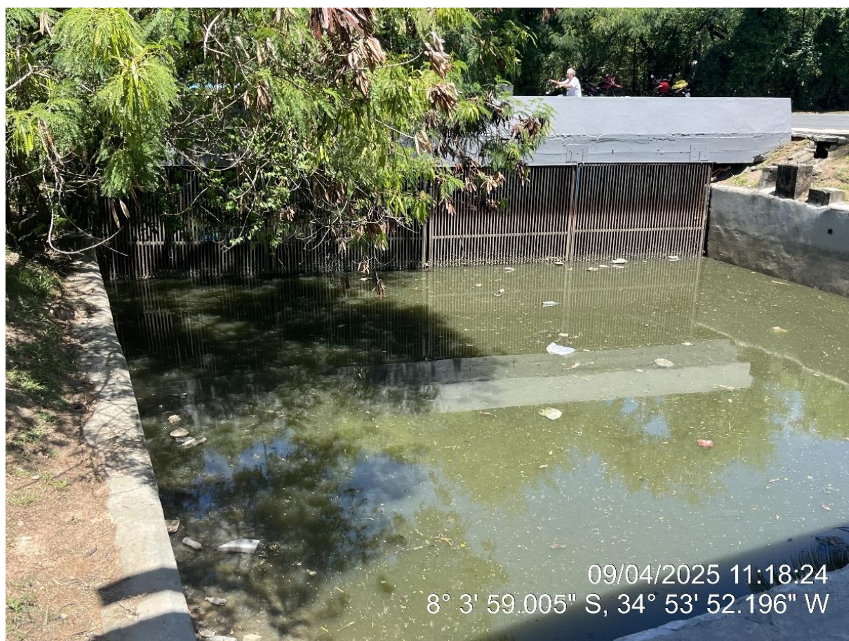
Sistema de gradeamento para retenção de sólidos
