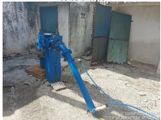
Poço São Cristóvão, com estrutura em mal estado de conservação
