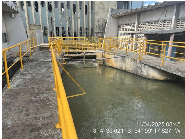
Calha Parshall com aplicação de coagulante
