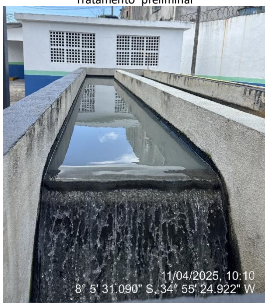
Tanque de contato
