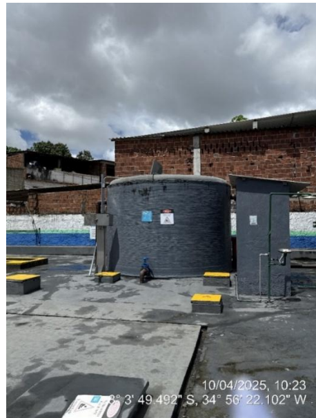
Tanque de contato
