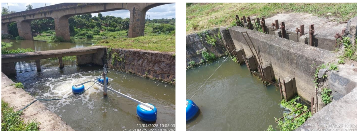
Figura 4.15 – Captação no Rio Capibaribe (Tiúma)
