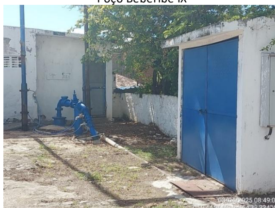
Poço Hidelbrando de Vasconcelos II
