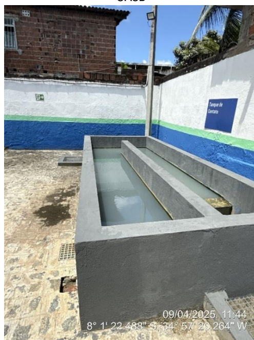
Tanque de contato
