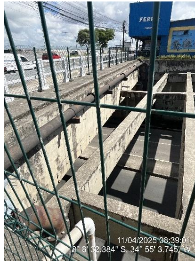
Tubulação de recalque
