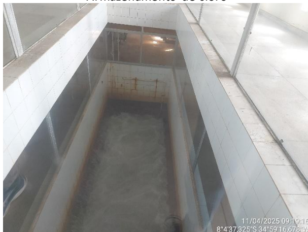
Canal de saída dos filtros
