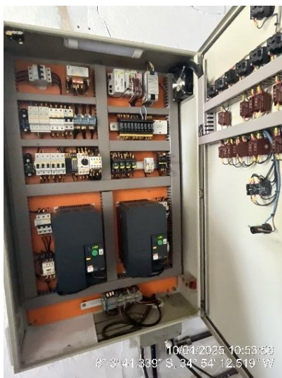
Quadro de comando
