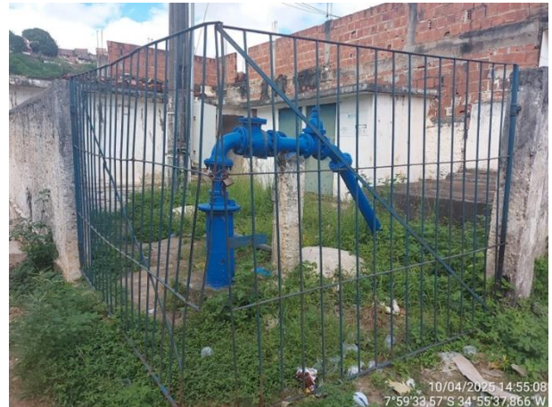
Poço Fluminense 2, com proteção precária e ausência de identificação
