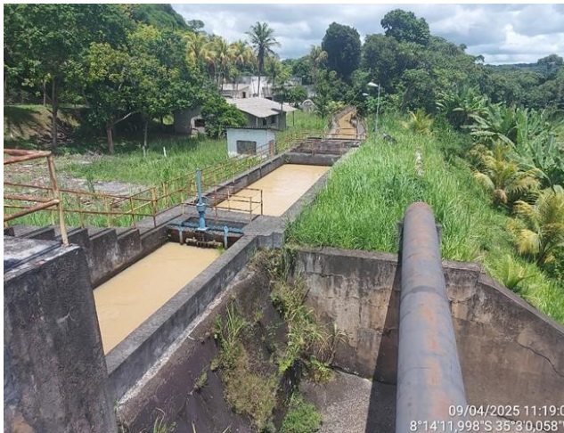
Desarenador e canal de adução de água bruta
