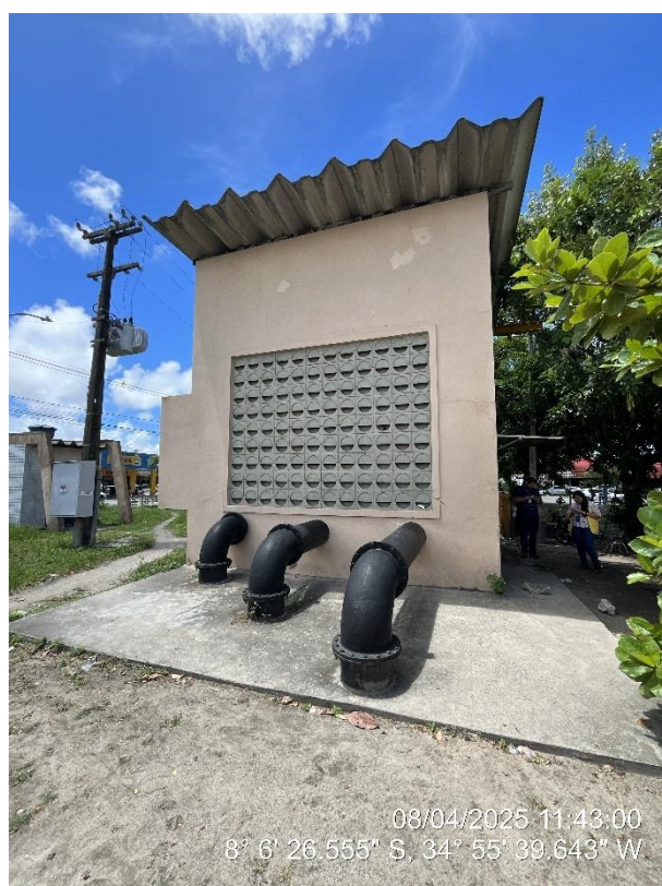
Tubulação de recalque
