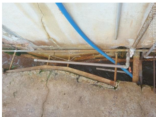
Chegada de água bruta em calha parshall com aplicação de coagulante
