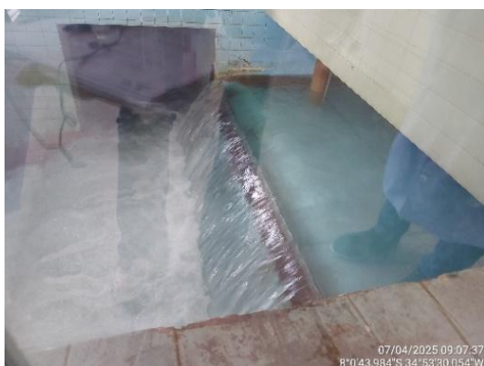
Saída da água tratada
