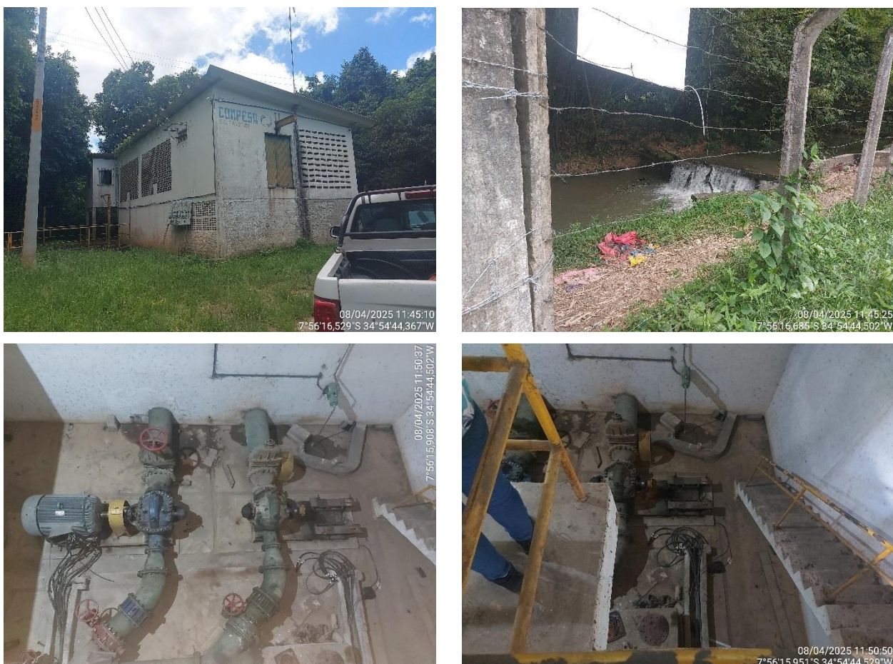
Figura 4.42 – Estação Elevatória de Água Bruta Paratibe
