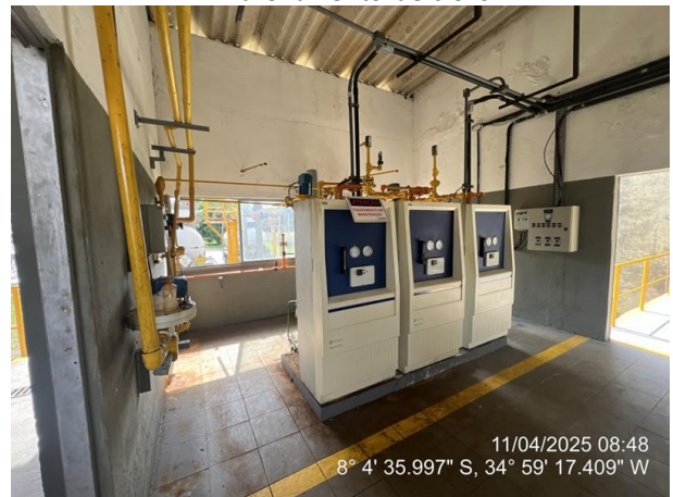
Sistema de bombeamento de cloro
