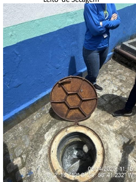
Saída do efluente tratado
