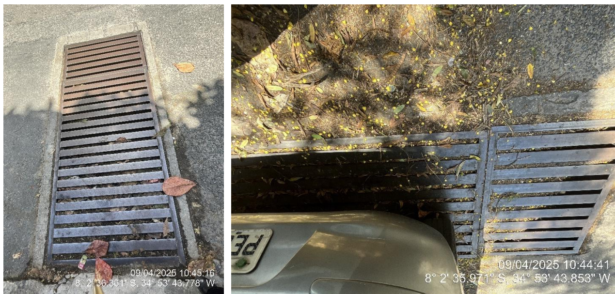
Figura 7.34 – Grades de ferro – Reservatório na Rua Santo Elias
