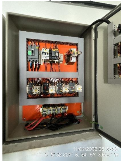
Quadro de comando
