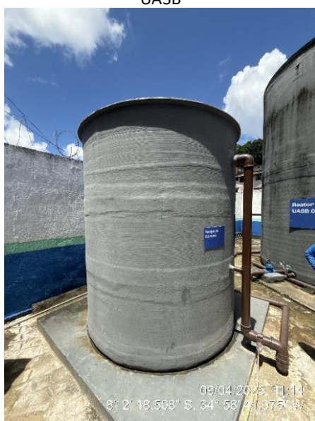
Tanque de contato
