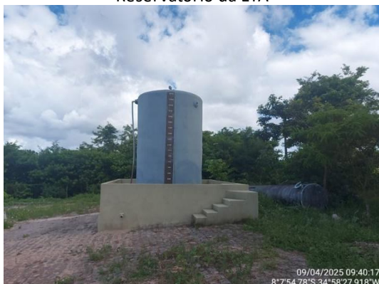
Armazenamento de sulfato de alumínio
