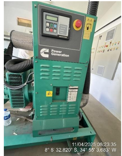
Gerador de energia
