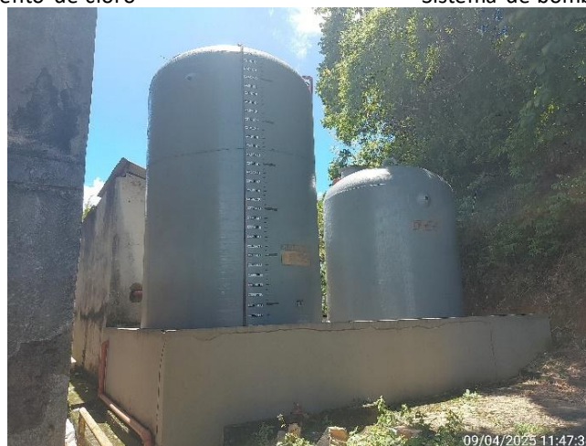
Armazenamento de sulfato de alumínio
