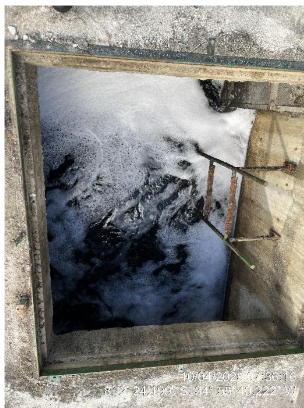
Aeração no reservatório para pré-tratamento
