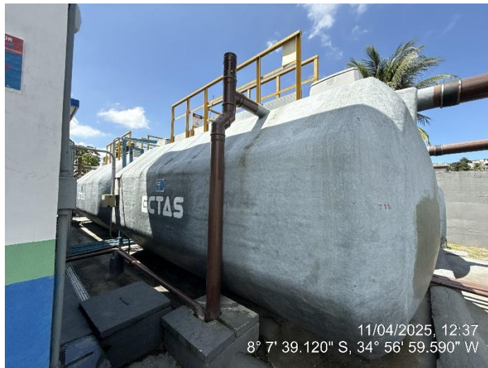
Tanque retentor de sólidos
