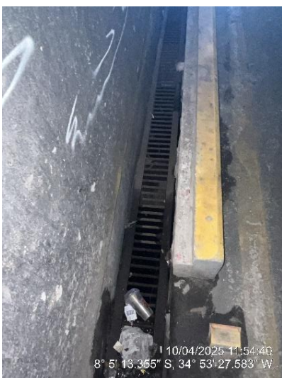
Ponto de coleta de águas pluviais
