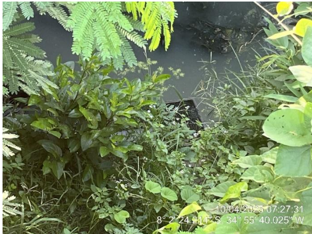
Cesto gradeado para retenção de sólidos
