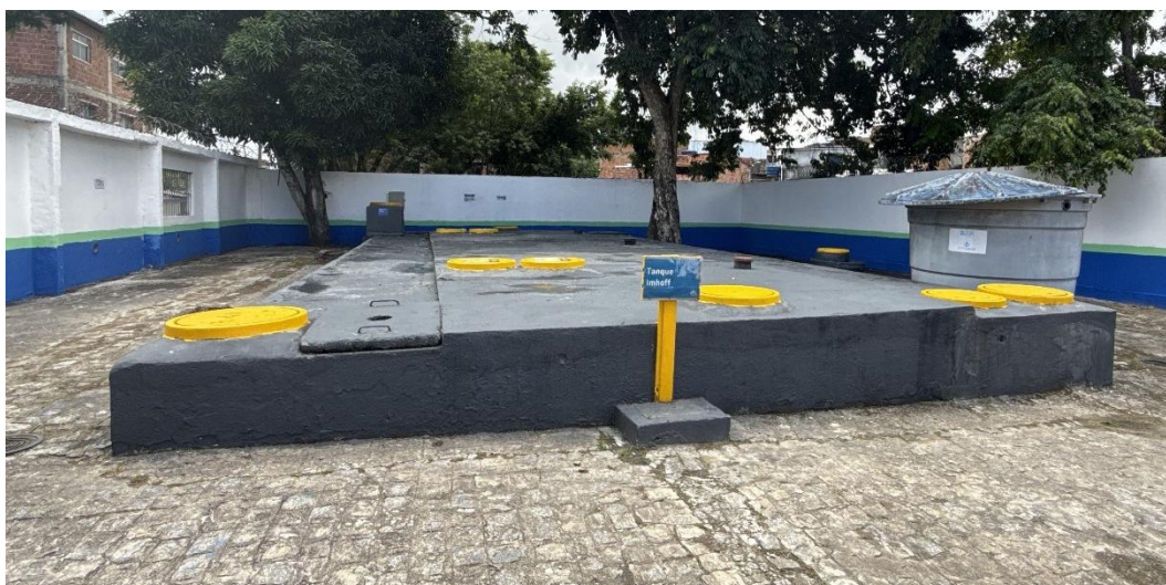
Figura 5.25 – ETE Jardim Planalto
