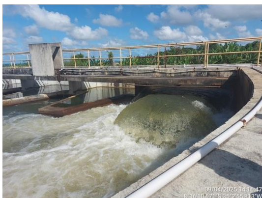
Chegada de água bruta com aplicação de peróxido de hidrogênio
