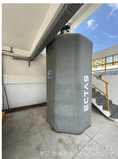
Tanque de lodo
