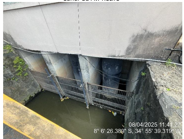
Bombas de recalque
