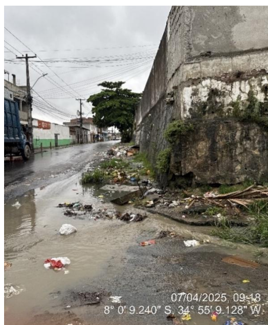
Ponto de lançamento de esgoto – Av. Ver. Octacílio Azevedo
