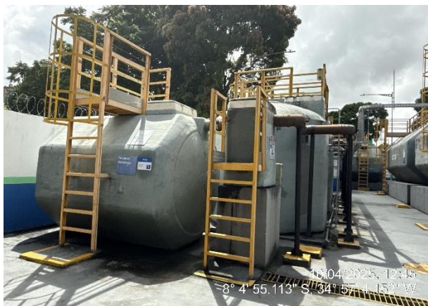
Tanque de Desinfecção
