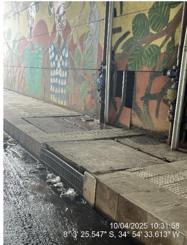
Ponto de coleta de águas pluviais. Tubulação de recalque
