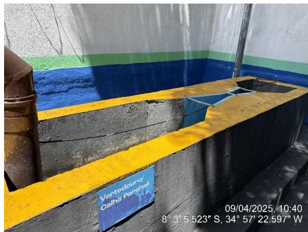
Saída efluente tratado
