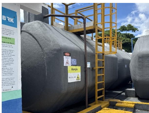
Tanque retentor de sólidos
