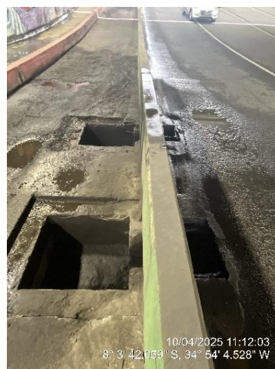
Ponto de coleta de águas pluviais
