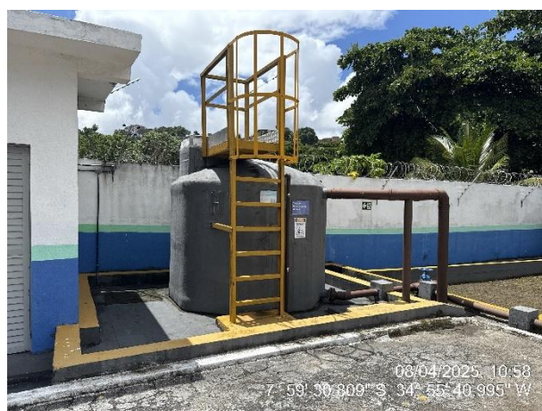
Tanque reservatório de lodo
