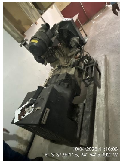
Gerador de energia
