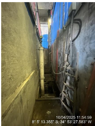
Tubulação de recalque
