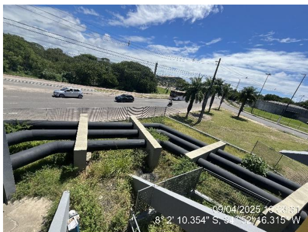
Tubulação de recalque
