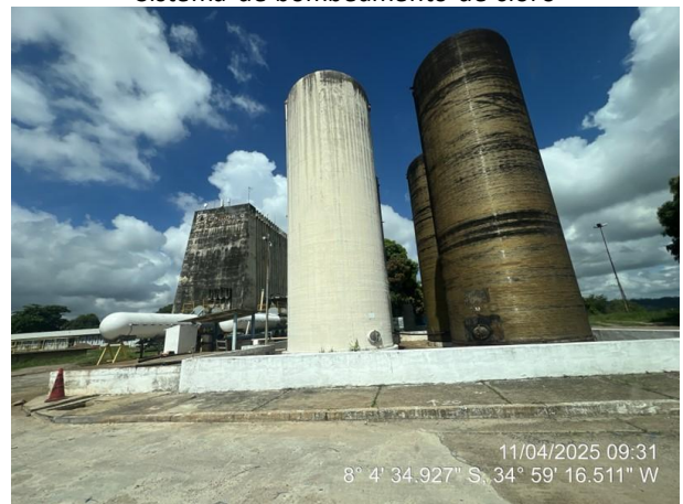
Armazenamento de sulfato de alumínio
