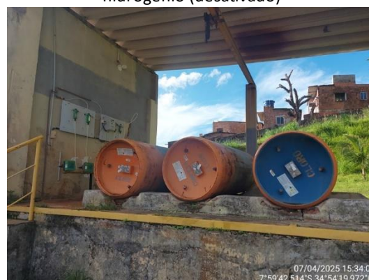
Armazenamento de cloro gás
