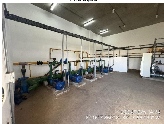
Sistema de bombeamento de cloro
