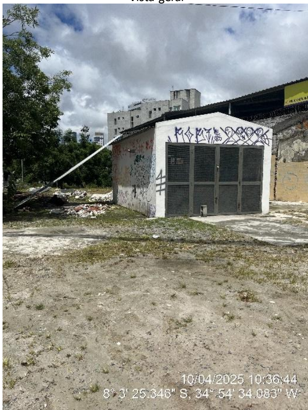
Casa de bombas
