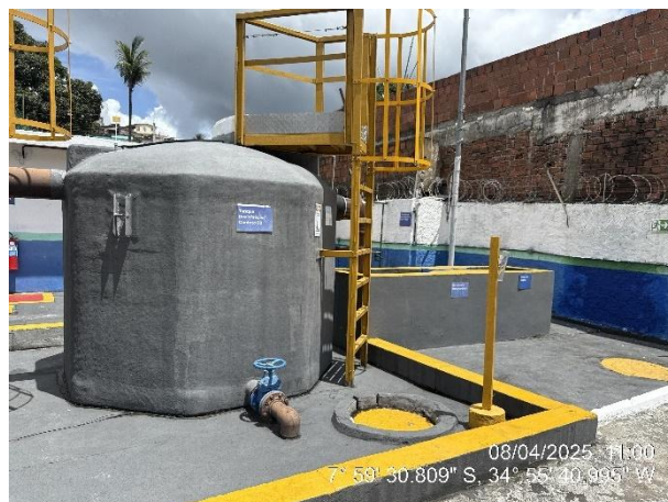
Tanque de contato
