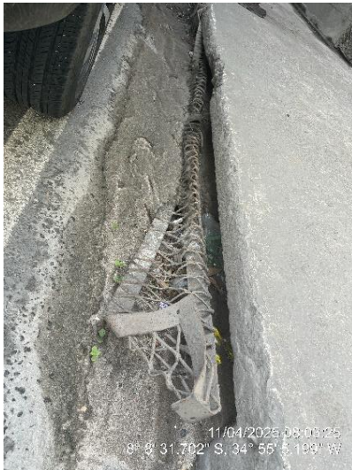
Ponto de coleta de águas pluviais
