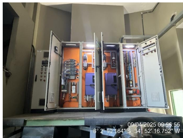
Quadro de comando
